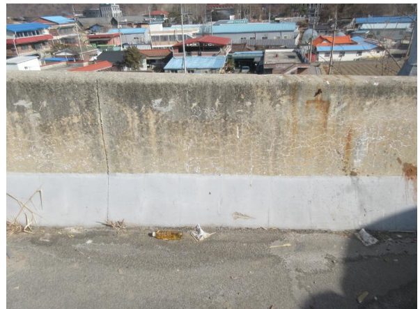
방호벽 망상균열 및 백태 S1
