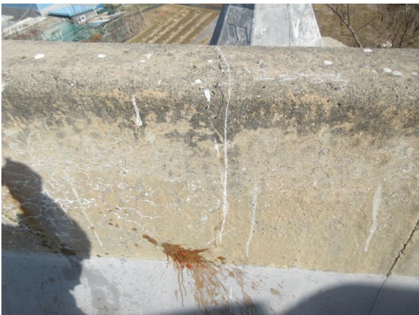
방호벽 균열(0.3mm미만) S1
