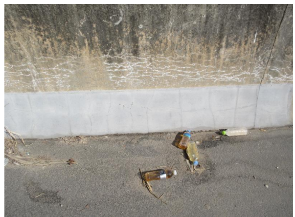
방호벽 망상균열 및 백태 S1
