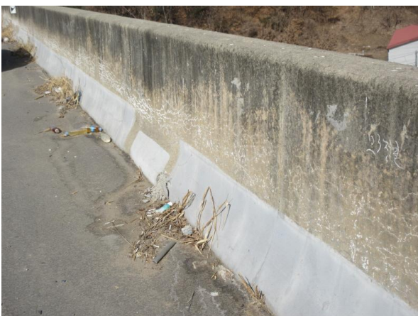
방호벽 망상균열 및 백태 S1
