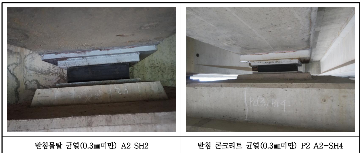
【사진 1.3.13】 교량받침 손상현황
